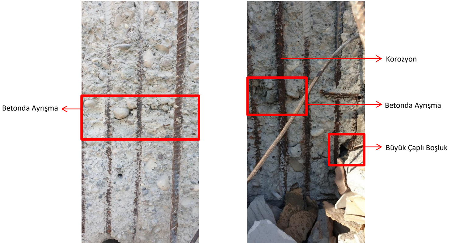
19-A: Betonda Ayrışma
