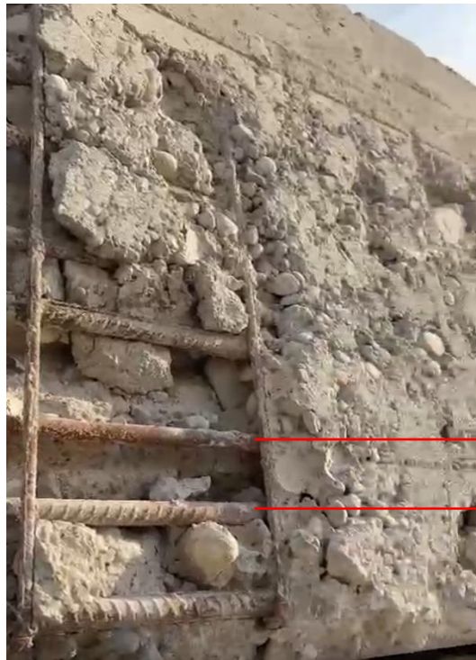
Resim 20: Grand Isias Otel Enkazında Tespit Edilen Kusurlu Beton Örtüsü Örneği
