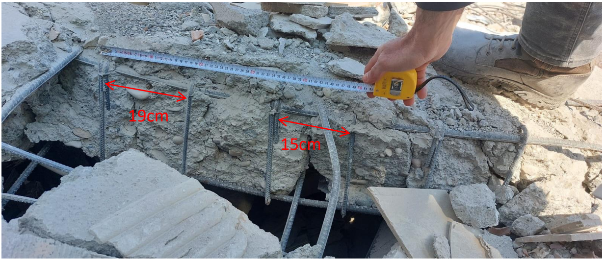
Resim 22: Grand Isias Otel Enkazındaki Kiriş Elemanından Ölçülen Etriye Aralığı
