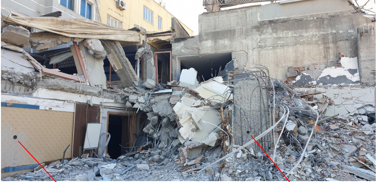
6-C: Numune No: 6 /Zemin Kat Kolon 2
