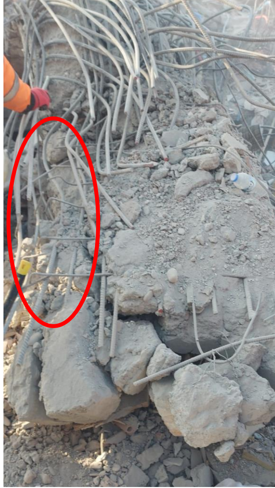
Resim 23: Grand Isias Otel Enkazındaki Kolon Elemanının Açılan Etriye Kancaları
