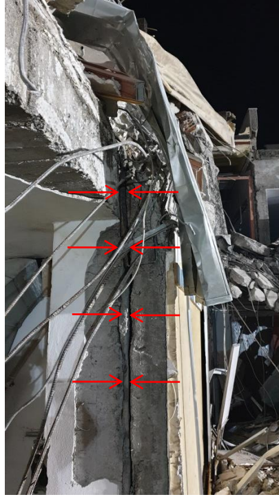
Resim 31: Grand Isias Otel Binası ile Güney Bitişindeki Tek Katlı Bina Arasındaki Derz Boşluğu
